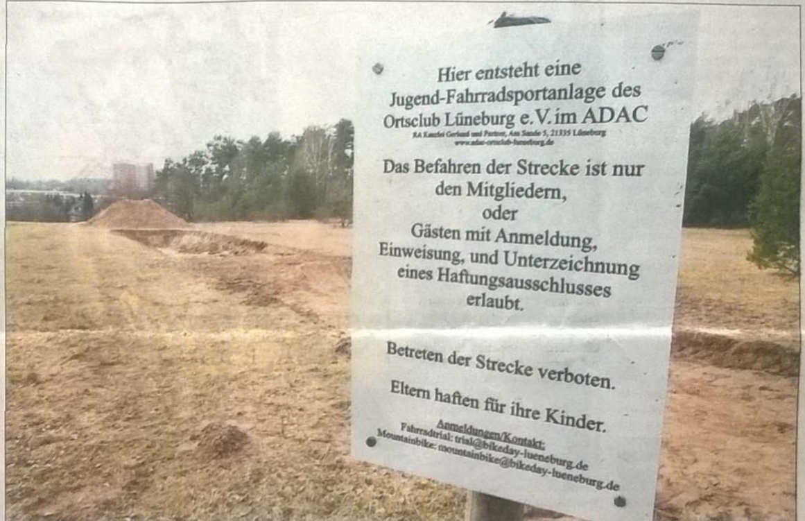
Aufgeschüttetes Erdreich und ein Graben, viel mehr ist aktuell noch nicht zu sehen. Doch das Schild an der Baustelle gibt Aufschluss, was der ADAC in Kaltenmoor plant.
